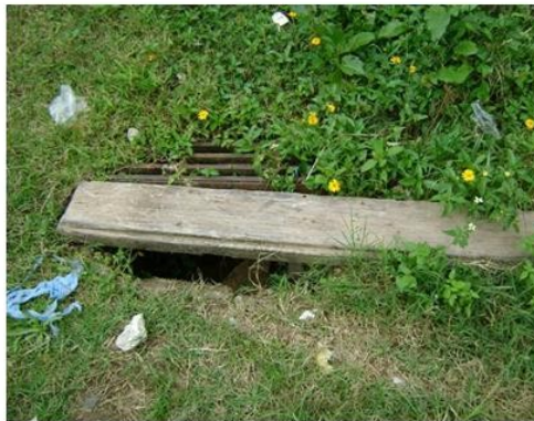
Figura 23: Canaleta parcialmente entupida e que não dá vazão ao grande volume de água durante as chuvas intensas. Foto F. S. Lima.
