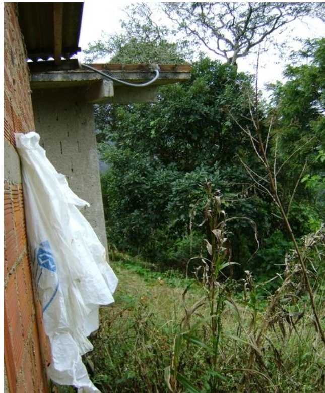
Figura 28: Casas construídas no limite do topo da encosta aterrada. Foto F. S. Lima.
