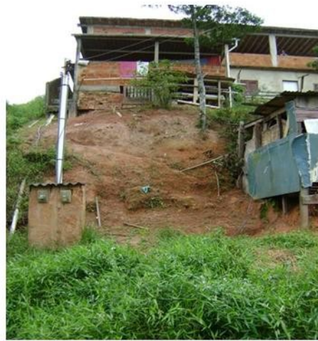
Figura 18: Aspecto estrutural de casa na parte de cima da Rua Minas Gerais. Foto F. S. Lima.
