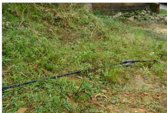
Figura 9. Detalhe de cano de abastecimento ilegal de água. Notar os remendos com fita isolante nos canos, e o constante vazamento de água. Foto F. S. Lima.
