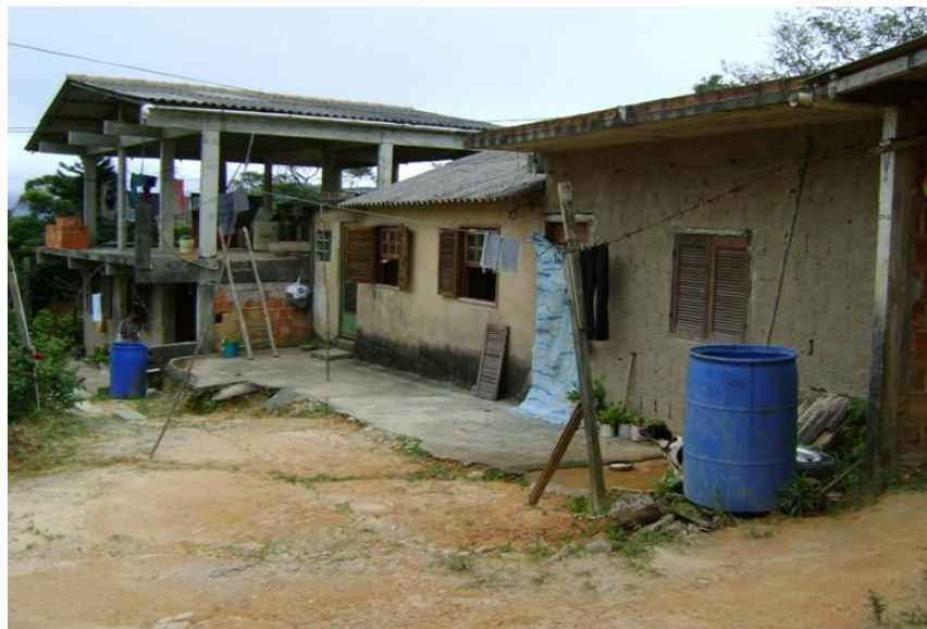
Figura 27: Casas construídas no topo da encosta aterrada. Casas sem calha e com processo de ravinamento do terreno. Foto F. S. Lima.
