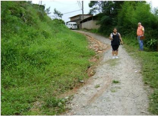
Figura 17: Acesso ao início da Rua Minas Gerais – parte 3. Observe o estado da via por onde passam pedestres e alguns Veículos. Presença de ravinamento. Foto: F.S.Lima
