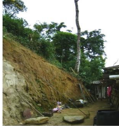
Figura 12: Corte de talude nos fundos de uma casa. F. S. Lima.
