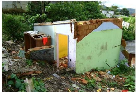
Figura 5: Detalhe da casa atingida pelo deslizamento de terra. Casa construída sob depósito de tálus. Foto F.S. Lima.
