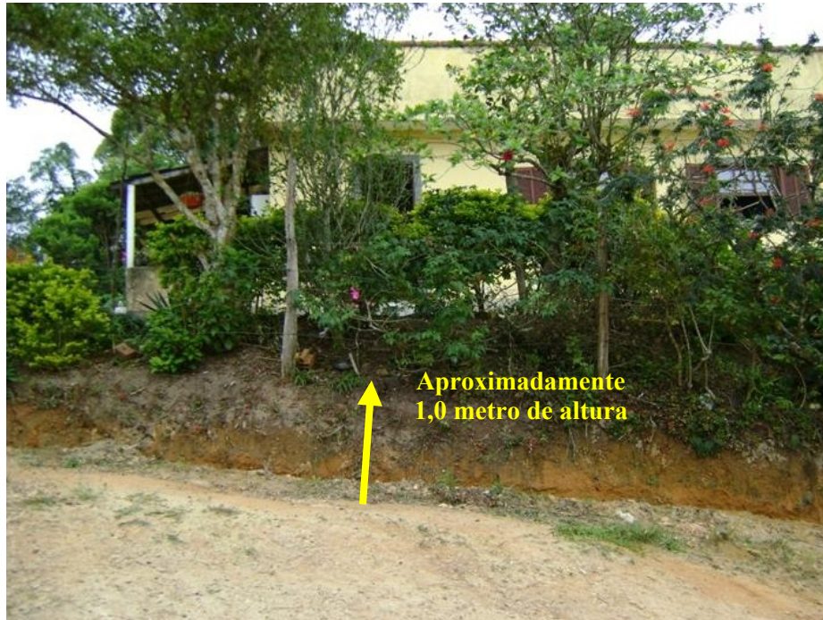
Figura 26: Aterro colocado pela população no início da ocupação dessa localidade. Atualmente essa diferença de altura vem aumentando devido à erosão do sopé desse pequeno corte. Foto F. S. Lima.
